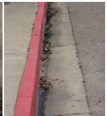
Fuga hidráulica vial
